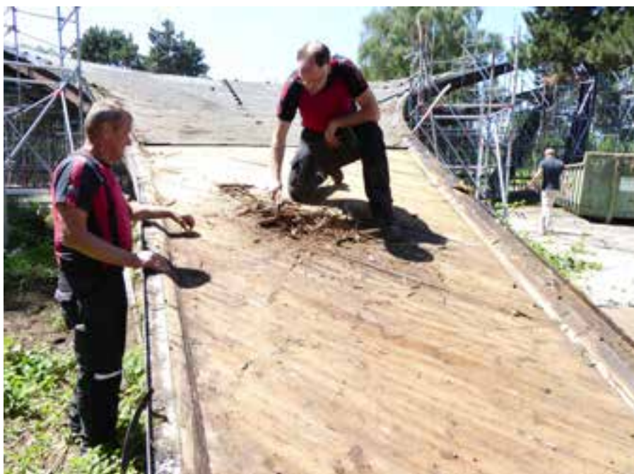
Auch die hölzerne Dachmembran wies, insbesondere durch zu hohen Feuchteintrag, starke Schäden auf.
