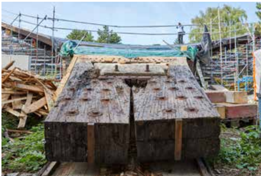
Insbesondere die Tiefpunkte des Segels waren durch Nässe und Feuchtigkeit stark beschädigt und mussten komplett erneuert werden. Der Bodenabstand war zu gering.
