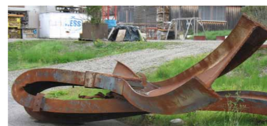
Verkrümmter Stahlträger nach dem Brandfall.
